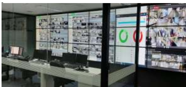
Figura 2 – Centro de Controle Operacional
